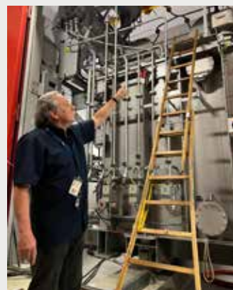
Ein EWZ-Mitarbeiter erklärt die komplexen Anlagen.
