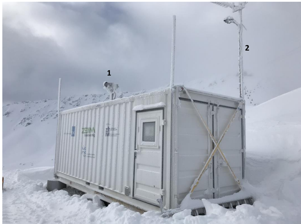
Abbildung 18: Messcontainer der PV-Versuchsanlage Totalp. Bietet Platz für die Energiemeter sowie die Installationen für den Betrieb und die Datenübertragung der Anlage. Auf dem Dach befindet sich ein zweiachsiger Tracker (1), auf der Seite befindet sich ein Mast (2) mit Mobilfunkantenne, Webcams und Pyranometern.
