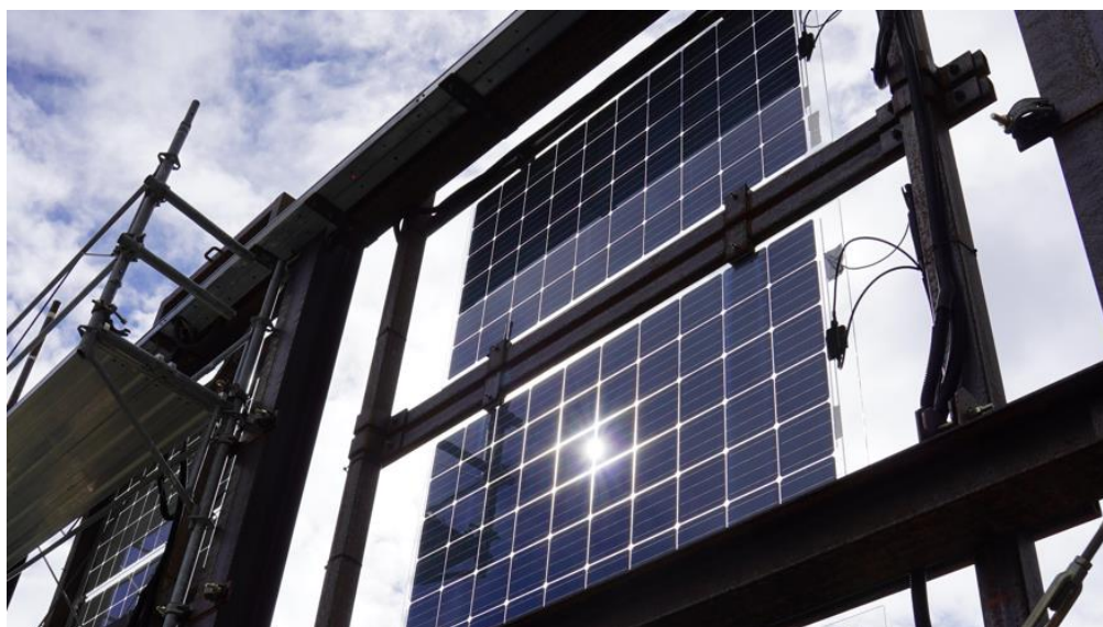
Abbildung 13: Die Segmente D und E wurden für die Montage von bifazialen PV-Modulen konzipiert. Die Verschattung der Rückseite der Module wird minimiert.
