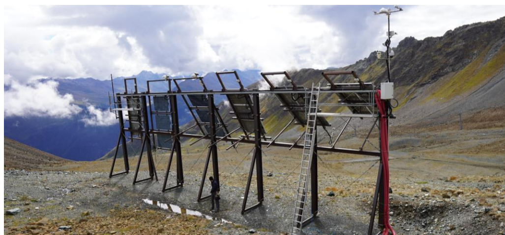
Abbildung 3: PV-Versuchsanlage Totalp von Nordwesten.
