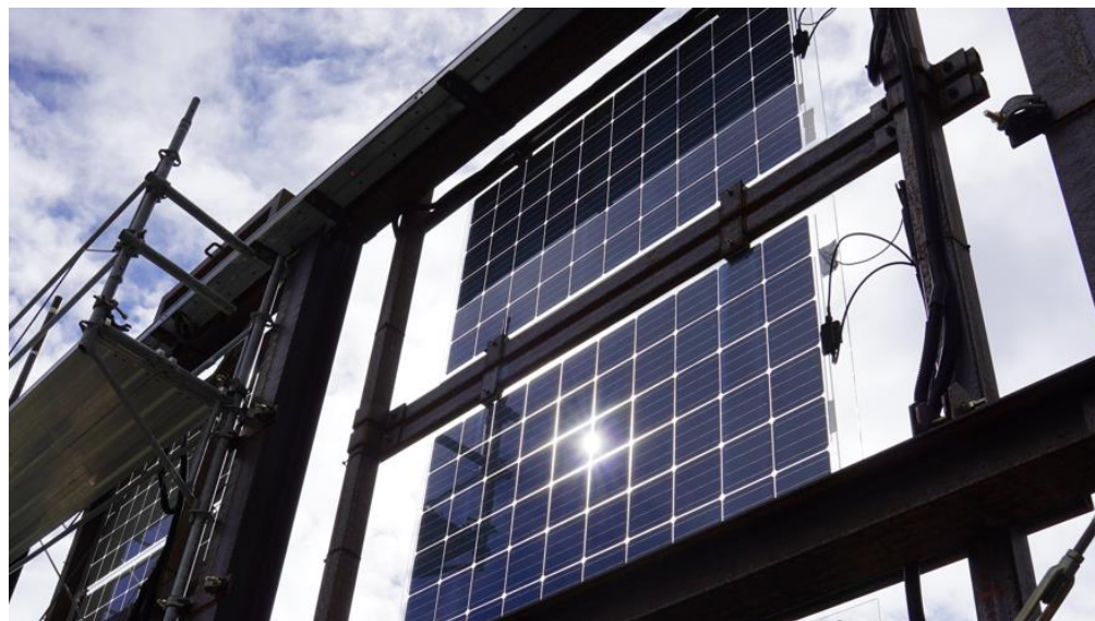
Abbildung 13: Die Segmente D und E wurden für die Montage von bifazialen PV-Modulen konzipiert. Die Verschattung der Rückseite der Module wird minimiert.
