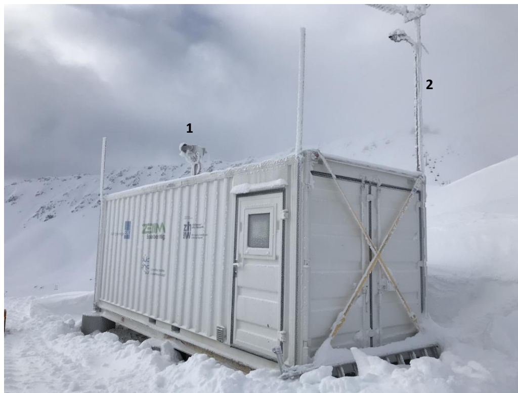
Abbildung 21: Messcontainer der PV-Versuchsanlage Totalp. Bietet Platz für die Energiemeter sowie die Installationen für den Betrieb und die Datenübertragung der Anlage. Auf dem Dach befindet sich ein zweiaxiger Tracker (1), auf der Seite befindet sich ein Mast (2) mit Mobilfunkantenne, Webcams und Pyranometern.
